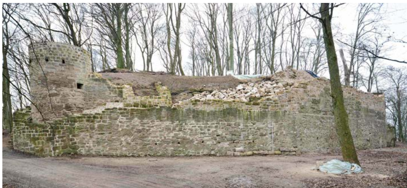
Zabelstein, Frontansicht der Hauptburg von Nordosten nach Abschluss der Baumaßnahme 2014 (Foto: Büro für Burgenforschung, Joachim Zeune)
