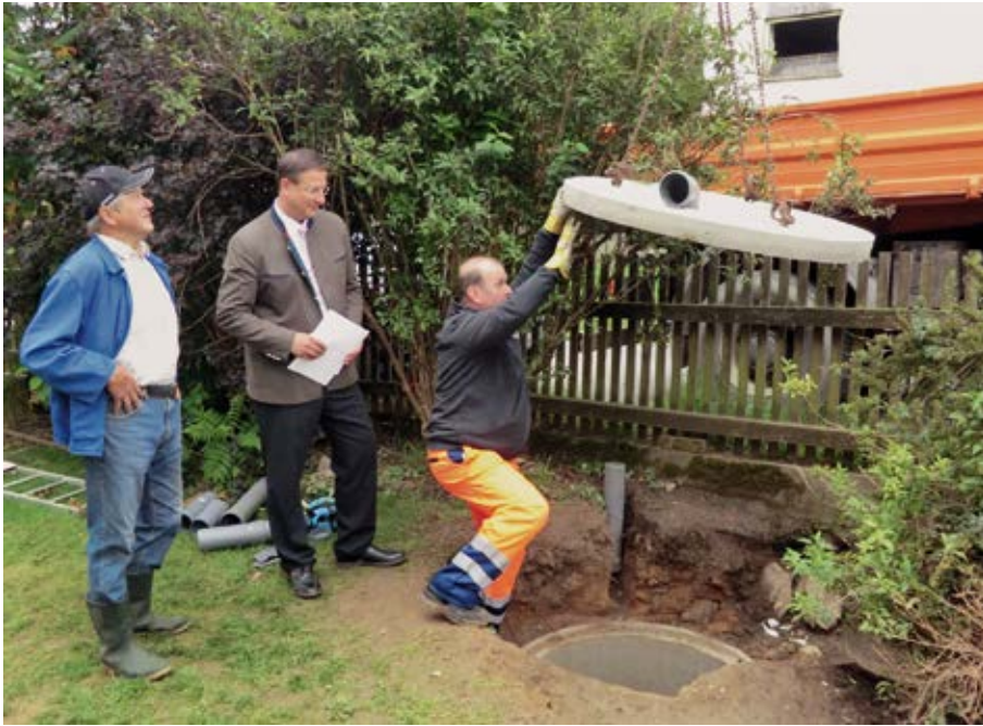
Grasfilzing, (v.l.n.r.) Besitzer Xaver Mühlbauer und der stellvertretende Landrat Markus Müller beobachten, wie Alwin Lankes vom Kreisbauhof Cham den Sicherungsschacht mit einer Deckplatte verschließt (Foto: BLfD, Christoph Steinmann)
